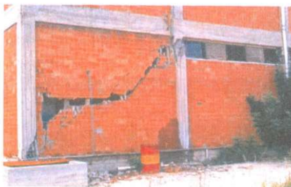
▲ شکل ۹- در مورد این ساختمان، دیوار آجری مقاوم‌تر از ستون‌هاست و باعث شکست برشی در ستون‌ها گردیده‌است (Adana-Ceyhan, Turkey 1998). ترکیب شکست ستون کوتاه و شکست برشی ستون
