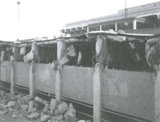
▲ شکل ۳- شکست ستون‌های کوتاه
